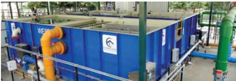
Plantas modulares de tratamiento de agua en la PTAP El Milagro
