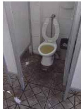
Mal uso de los servicios higiénicos.
